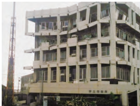
地震により損壊した宇土市庁舎
