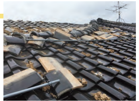
屋根瓦の被害が多かった
