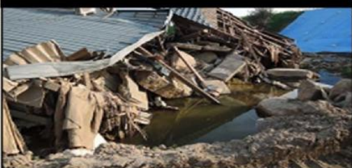
土石流の被害を受けた住宅
