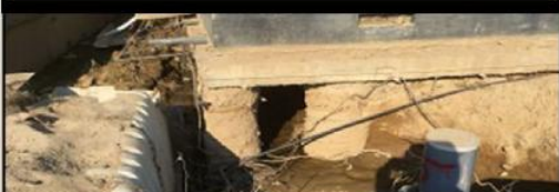
基礎下部が流失した住宅
