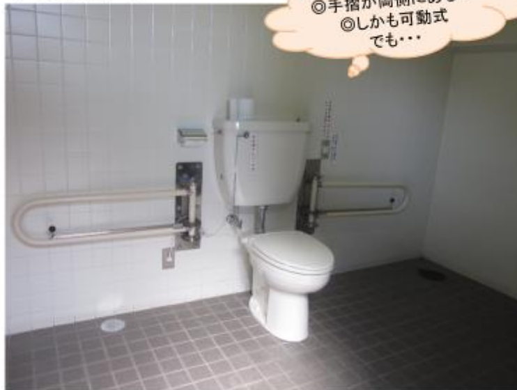
車いす対応トイレ
