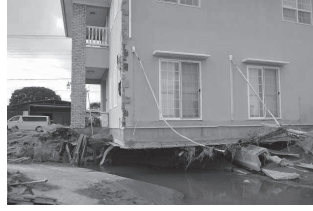
◆破堤近傍の建物③
