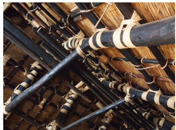
梁組は建築当時のままであるが、茅葺は更新され続け縄の結び方など技術の継承が見られる
