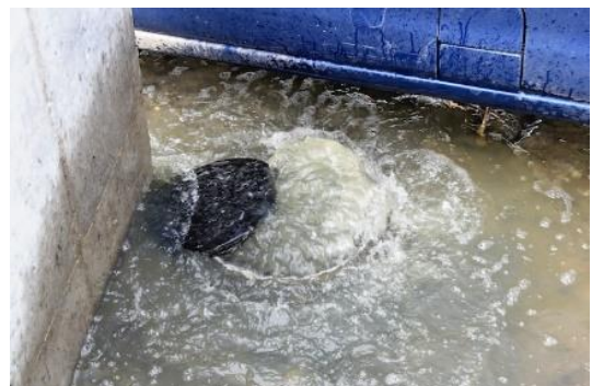
下水道処理場の冠水によりマンホールから汚水噴出（日本経済新聞から）
