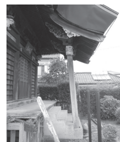
写真6 傾斜した柱（茨城県）
