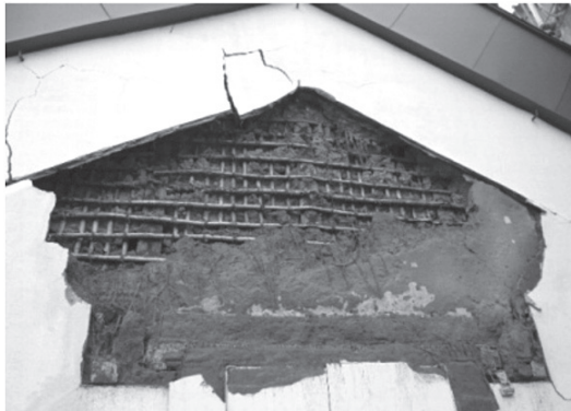
写真16 モルタル仕上げ層の脱落例
