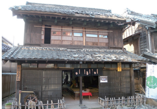
写真3. 屋根瓦の崩落により庇が損傷した民家(茨城県)
