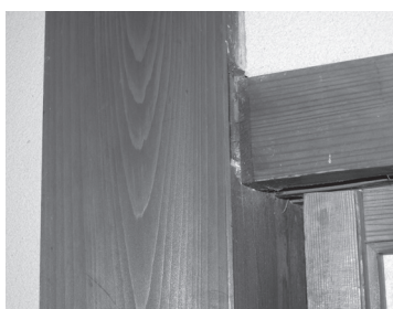
写真26 住宅の鴨居の脱落 (栃木県)
