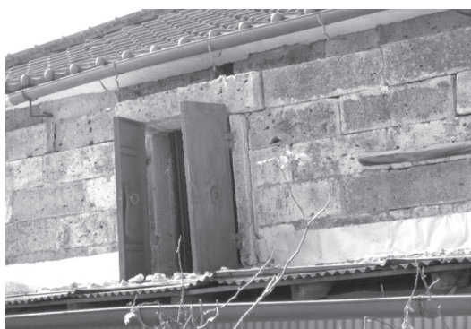
写真26 開口部のまぐさ付近の石材のずれ（栃木県）
