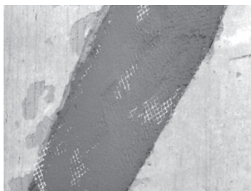
写真14 ひび割れ部の ガラスメッシュによる補強例
