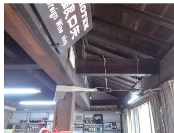
写真21 脱落予防のワイヤー (茨城県)
