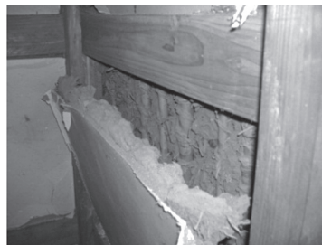
写真8 土壁の層間剥離
