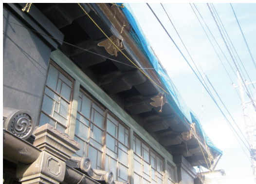
写真5. 樋受け金物の引き抜きによる軒裏の損傷(千葉県)
