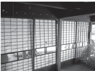
写真1-4 建具（障子）の破損
