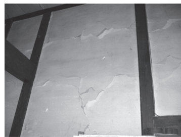
写真9 漆喰仕上げ層の浮き
