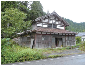
写真10 民家の応急措置 (石川県)
