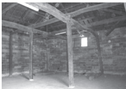
写真27 石壁のはらみによる繋ぎ梁の落下（東側面）（栃木県）
