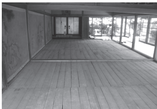
写真2 大書院の改修前状況
