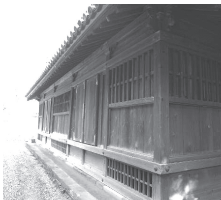
写真34 軸組が変形した近世建築(栃木県)
