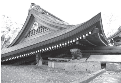
写真4 倒壊した鐘楼（栃木県）
