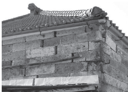
写真25 隅部の石積のずれ（北西隅）（栃木県）
