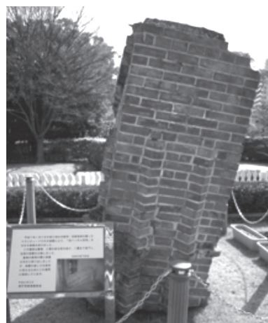
写真14 屋根面で折損して落下した煙突 （兵庫県）
