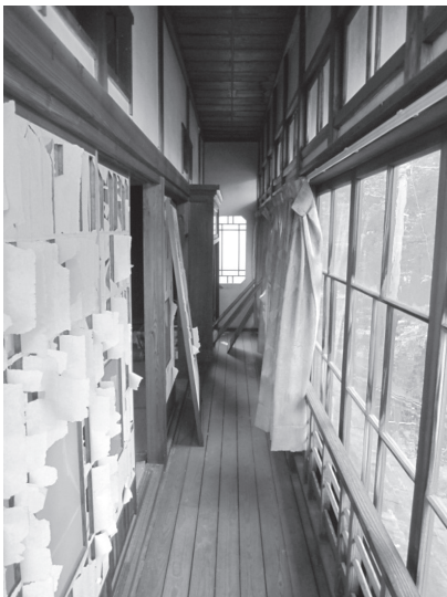
写真1-3 建具（障子）の破損
