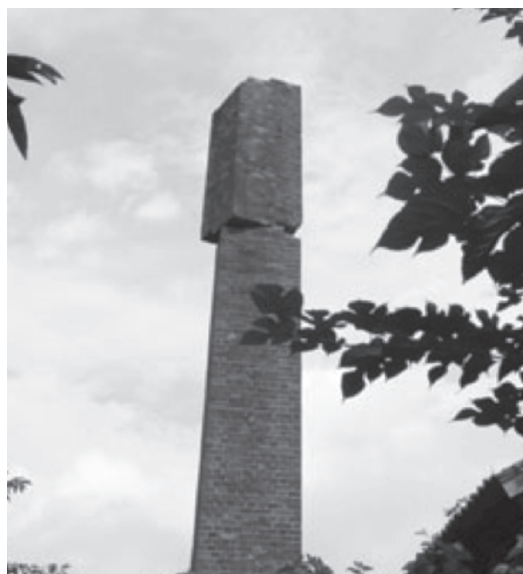
写真12 レンガ造煙突の被害（岩手県、未指定）
