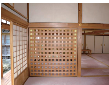
写真23 面格子の耐震化事例 (栃木県)
