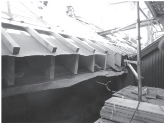
写真4 空葺きへの変更に伴う下地の調節（ルーフィング上面の木材）（千葉県） 下方の木材は土蔵の上面の覆い土を略すためのもの
