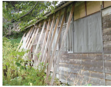
写真11 民家の応急措置 (石川県)
