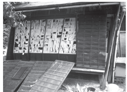
写真1-12 建具（障子）の破損と建具（坂戸）のはずれ
