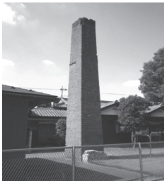
写真11 レンガ造煙突（埼玉県、未指定） 倒壊は免れたものの、危険な状態にある
