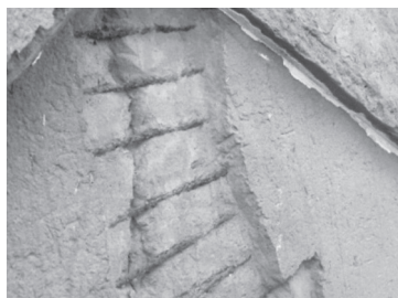
写真13 ひび割れ部の補強例
