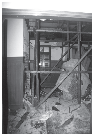
写真16 室内に落下した煙突（兵庫県）
