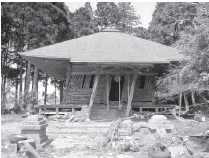
写真3 東日本大震災で大きく傾いた伝統構法の建物
