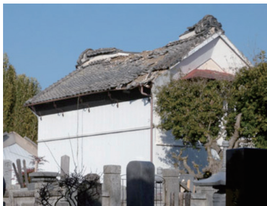
写真1. 大棟の中央部が崩落した土蔵（茨城県）
