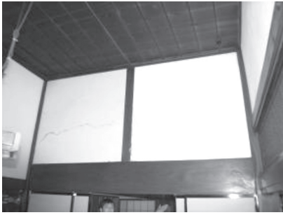
写真1-1 小壁の破損（貫伏せ部）
