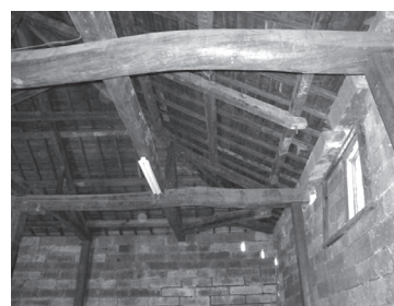
写真27 繫梁の脱落 (栃木県)
