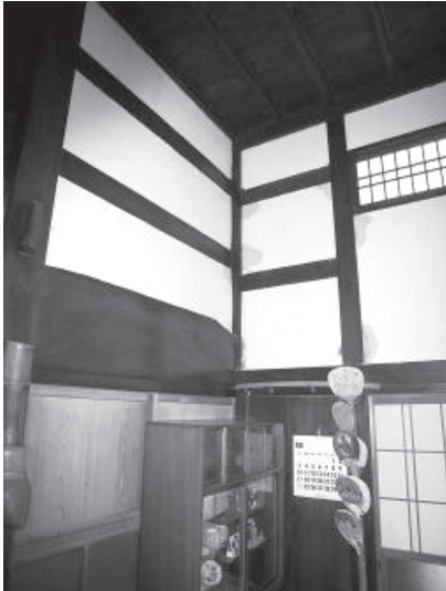
写真1-2 小壁の破損（柱チリ部）
