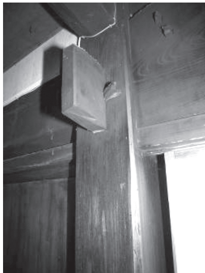
写真1-8 梁のずれ（鼻栓の破損）
