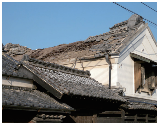
写真2. 下地の葺き土ごと屋根が崩落した民家（茨城県）
