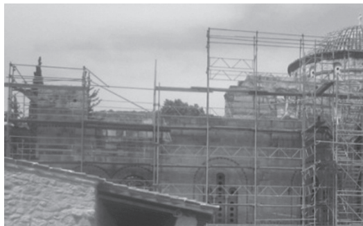
写真4 地震で被災後、応急対策が施された世界遺産ダフニー修道院（ギリシャ）
