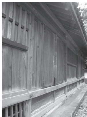
写真35 変形した軸組(栃木県)
