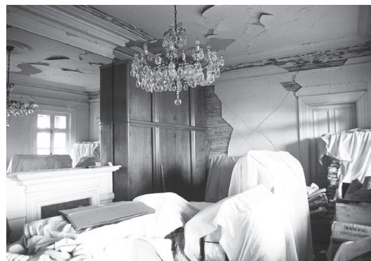
写真18 洋風建築の室内の漆喰仕上げの破損例
