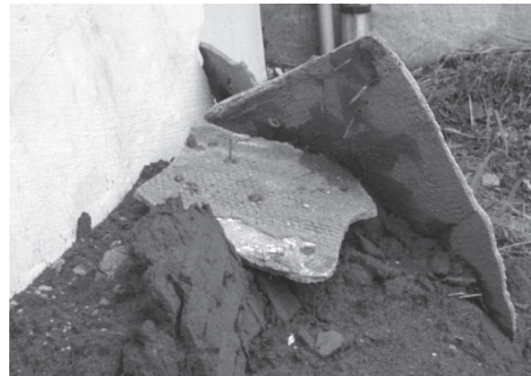
写真17 脱落したモルタル層
