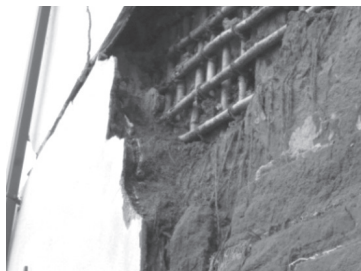
写真7 下げ縄の破断
