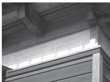
写真10 漆喰仕上げ層の脱落
