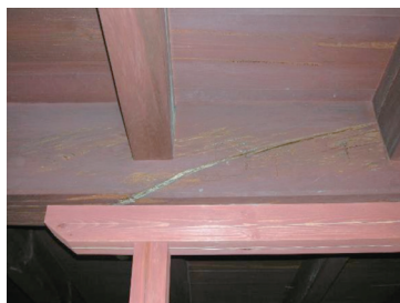
写真19 梁の亀裂 (愛媛県)
